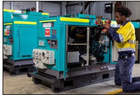
Instalação de Geradores e Manutenção Preventiva - UNIHEALTH Lda.
